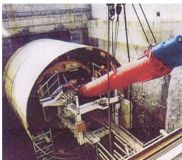
Slika 14. Montaža štita EPBM-a u tvornici i postavljanje pužastog transportera u polazno okno na gradilištu u Milanu
